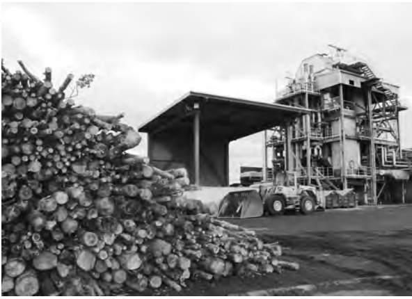
木材チップをガス化し、熱や電気などをつくる施設。原料の間伐材が積み上げられている＝オーストリア・ギュッシング
